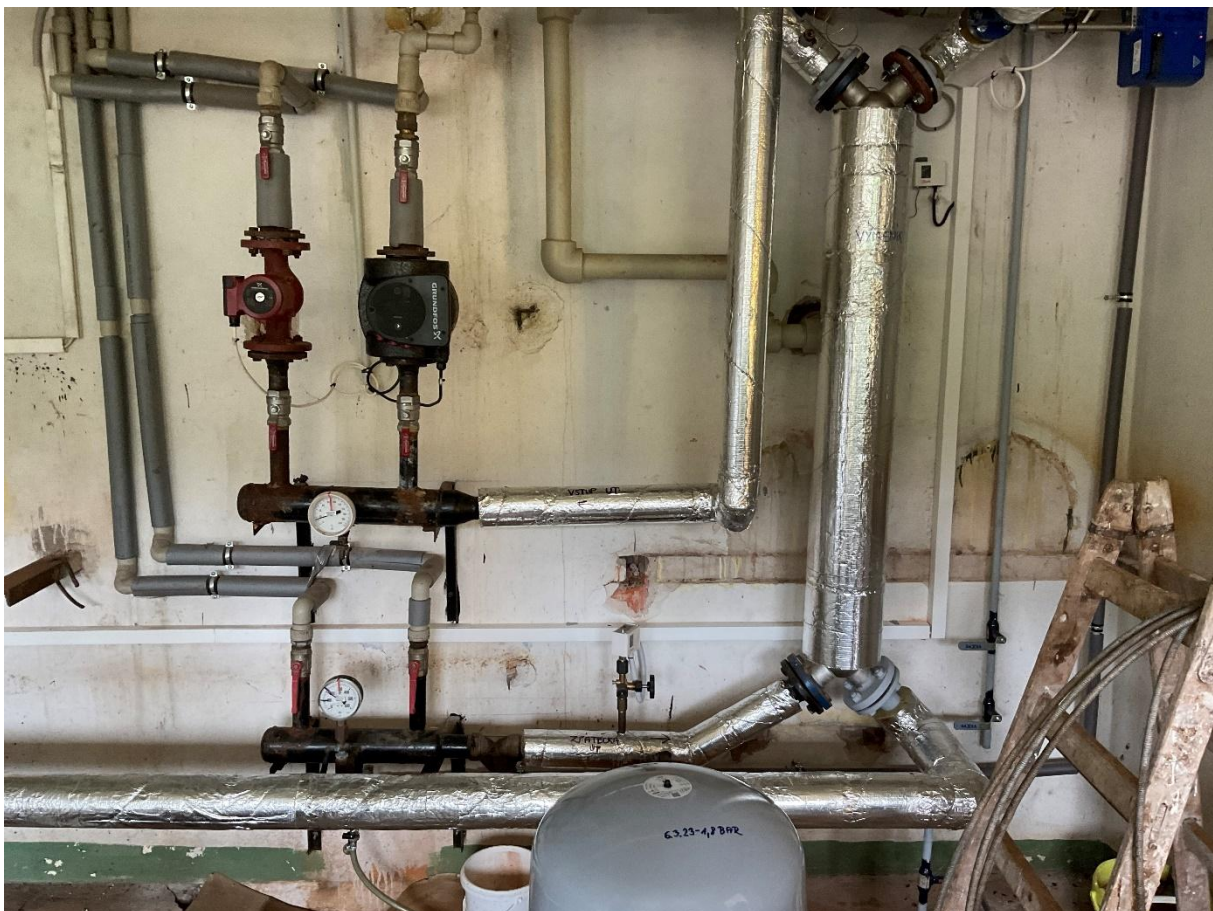
Obrázek 16 Rozvody TV v budově MŠ Janské Lázně Zdroj: místní šetření
